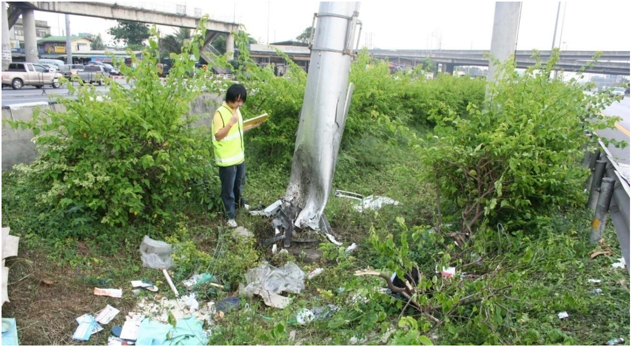
รูปที่ 3-6 ความเสียหายของเสาไฟฟ้าแบบสูง
